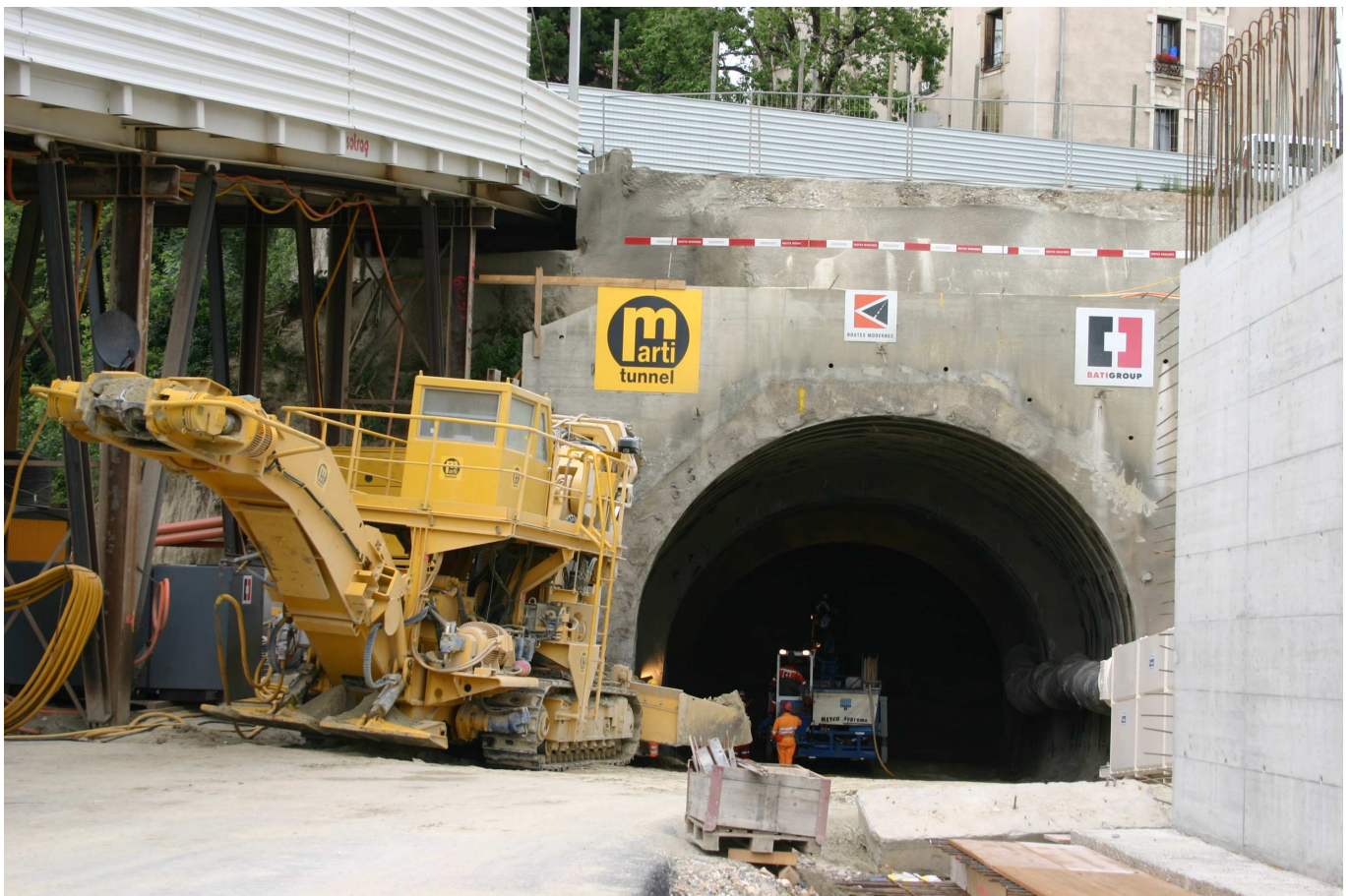
Le percement du tunnel de la Sallaz en direction des croisettes a débuté le 9 Juin dernier.
